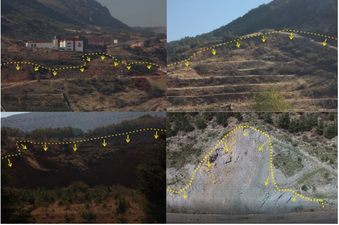
Şekil 2. Çalışma alanında önceden meydana gelmiş heyelanlar.
